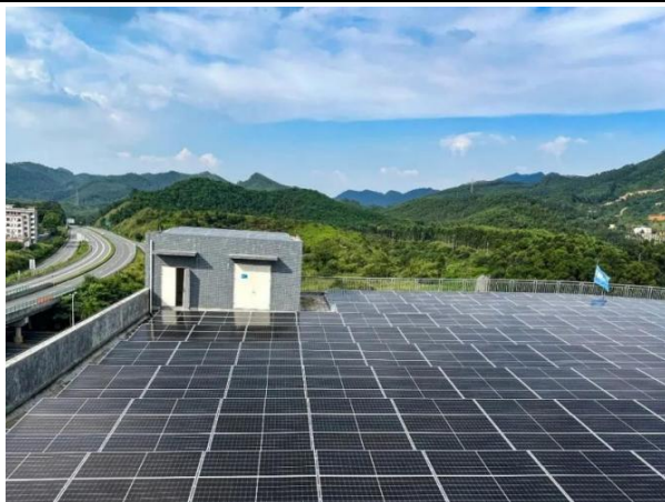
佛山科顺生产基地屋顶分布式光伏项目
