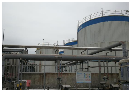
图 4.1-7 沥青储罐围堰
