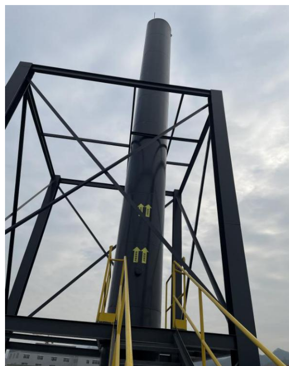
沥青卷材生产线废气排气筒（FQ-15206-10）
