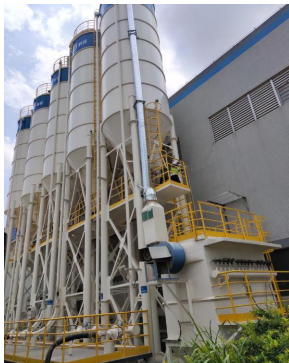
干粉砂浆废气排气筒 (FQ-15206-11)
