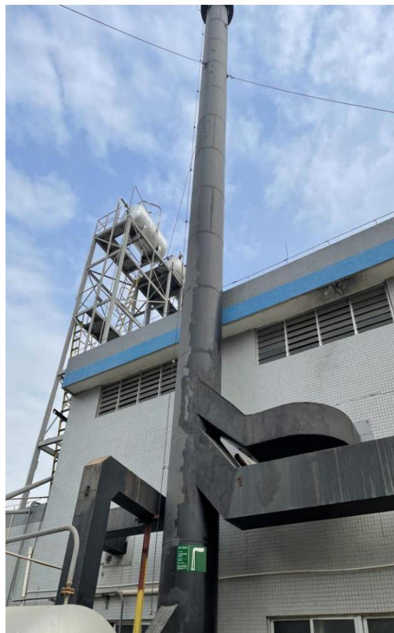
锅炉废气排气筒 (FQ-15206-1)
