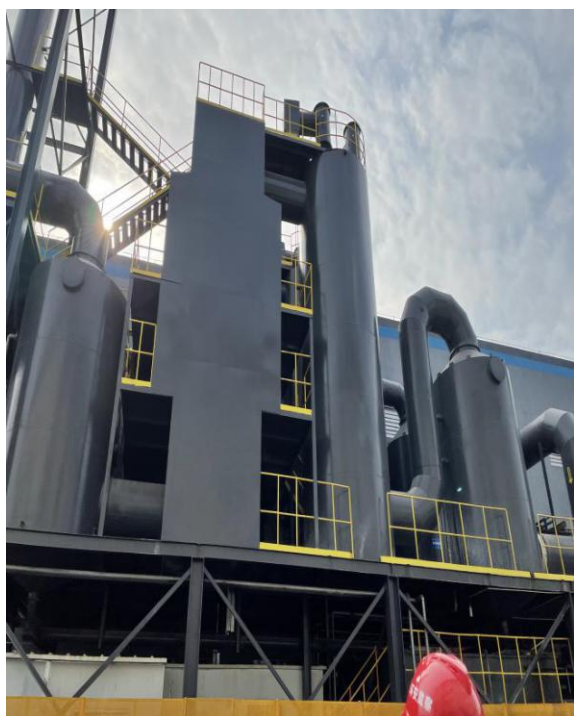
沥青卷材生产线废气处理设施
