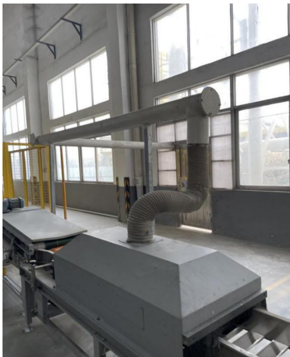
干粉砂浆废气收集
