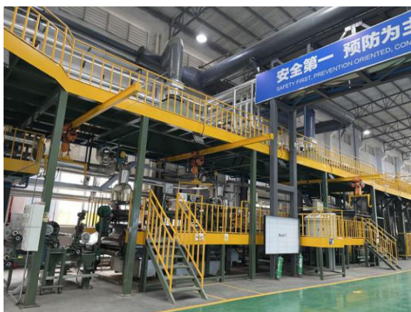
沥青卷材线配料、搅拌工序收集设施
